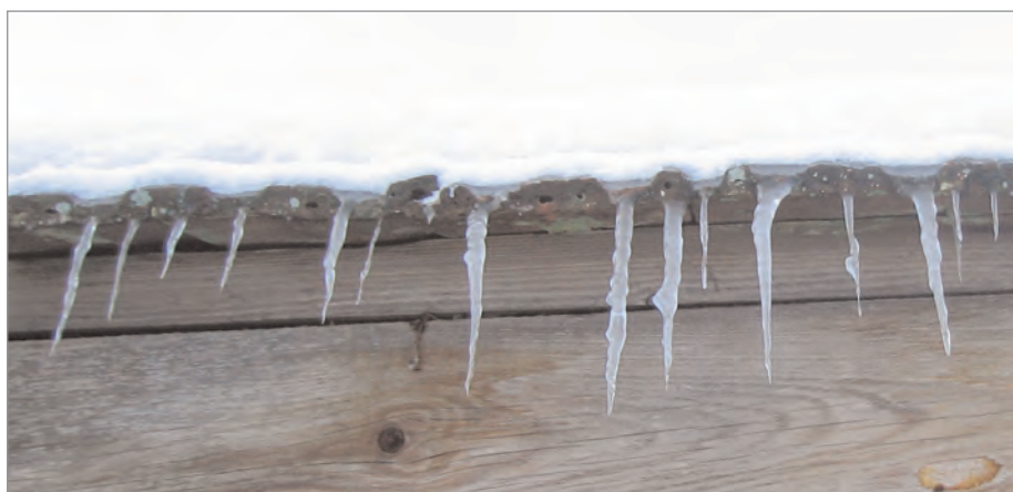
Střídáním tání a mrznutí sněhu vznikají na okraji střechy rampouchy neboli střechýle.
